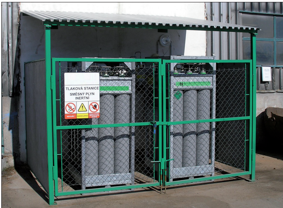
Ukázka tlakové stanice
